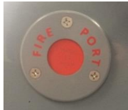
Feuerlöschöffnung auf der Backbordseite der Konsole
