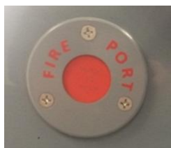
Feuerlöschöffnung auf der Backbordseite der Konsole
