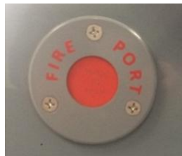
Feuerlöschöffnung auf der Backbordseite der Konsole
